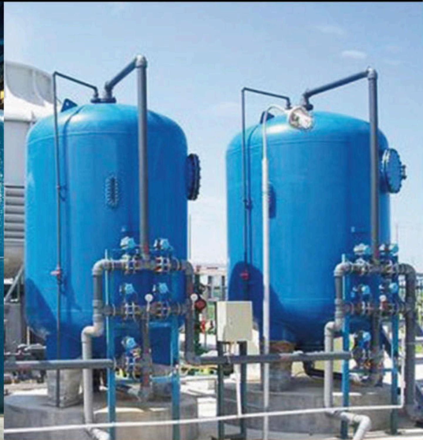
TANQUES DE AGUA
